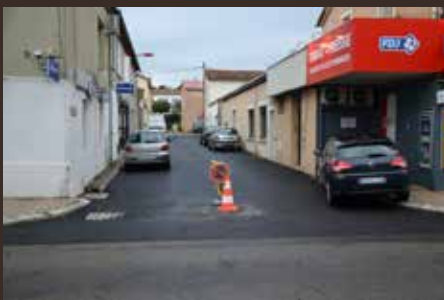
Aménagement des rives et de sécurisation des piétons route de Montèze et réfection de la rue du 19 Mars 1962.
