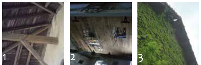
Une mise en sécurité de différents bâtiments publics, comme la maison 1940 au parc du Rouret (1 et 3) ou le foyer Sainte Marie (2) est devenue urgente, à la fois pour assurer la sécurité des passants et éviter une dégradation plus grave.
